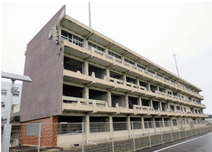
壁が無残にも削り取られた気仙沼市の東日本大震災遺構・伝承館
