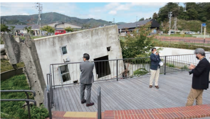
津波で基礎部分の杭が抜け、横倒しになった旧女川交番
